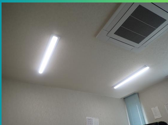
積算室 照明器具LED化後状況
